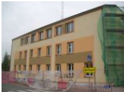
Ryc. Szkoła Podstawowa i Gimnazjum w Żytkiejmach podczas remontu (fot. T. Rydzewska)
